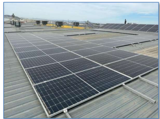
Imagen de la instalación fotovoltaica de la planta de Alacuás (Valencia)
